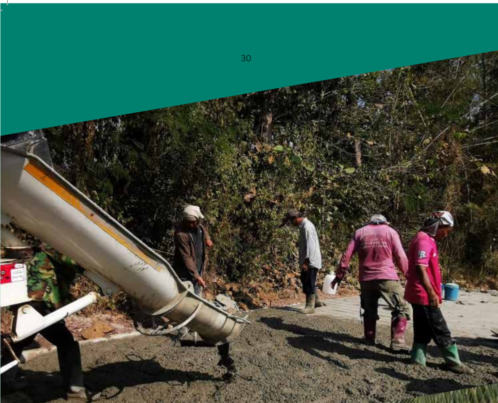
ก่อสร้างถนน คสล. ซอย 11 เข้มพระธาตุด้วยตมบ้านป็น
